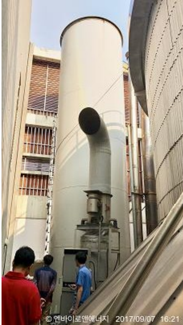
가스 배출 STACK
